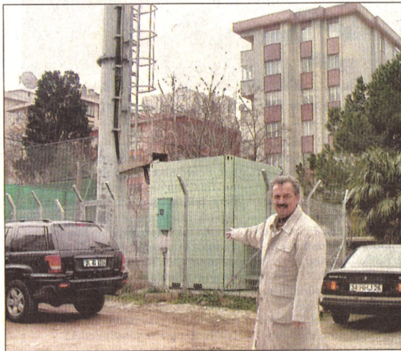
Feneryolu'nda bulunan bir baz istasyonu.....
